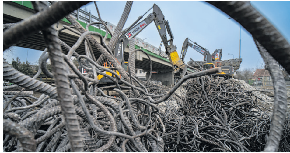
Dzisiaj połowa wiaduktu zamieniła się już w stertę gruzu i stalowych prętów
